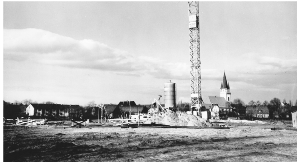
Das Seelzer Freibad wird gebaut (ca. 1966): Blick aus Südosten (durch ein Weitwinkelobjektiv) über die aufgeschüttete und planierte Junkernwiese zum alten Dorfkern um die Kirche. Links eine neue Reihenhauseszeile an der heutigen Humboldtstraße. Der Kran gehört der Seelzer Bau-firma Wilhelm Tölke.
